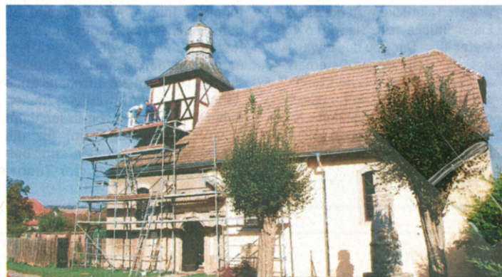
Neuer Außenanstrich für die Tröbsdorfer Dorfkirche. Der örtliche Männerverein hat für die Verschönerung gesorgt.
